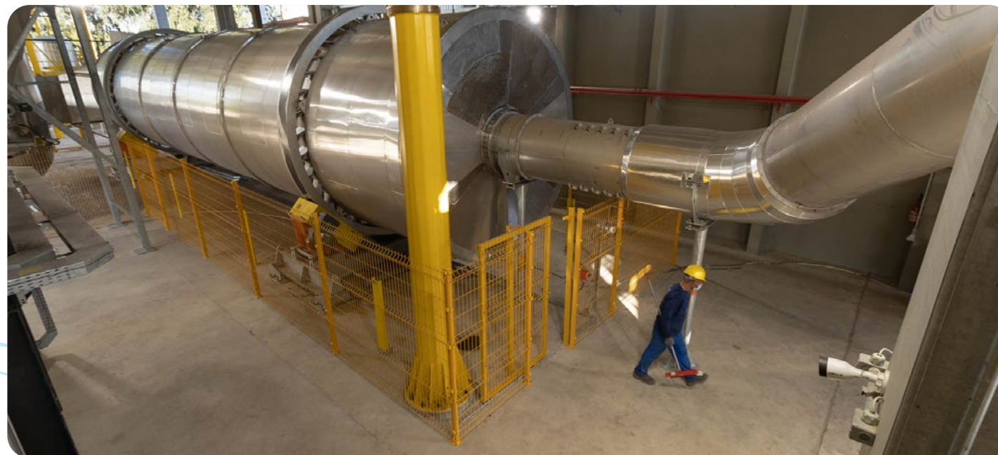
Combustor da ETE Atuba Sul - Fotógrafo: André Thiago Chaves Aguiar
